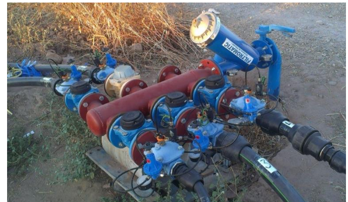
Figura 15. Toma de riego
