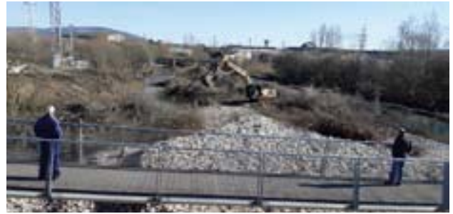
Actuación de recuperación de la capacidad de desagüe en el río Híjar (Cantabria) tras las crecidas de diciembre 2019.
