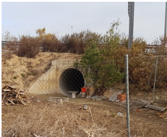
Drenaje transversal M-II ←
