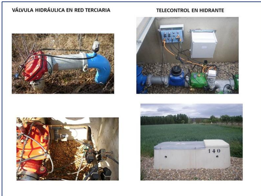
Figura 2. Instalación tipo del telecontrol en hidrante y en red.
