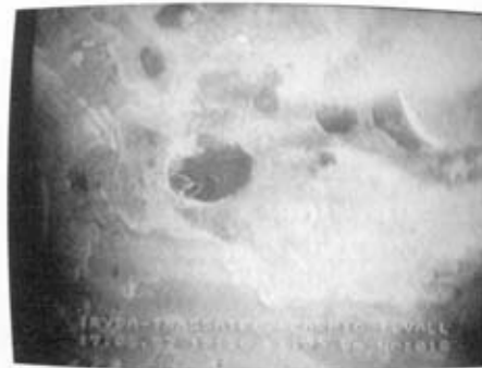
Fig. 10.46. Corrosión de la tubería de chapa de acero al carbono en zona de soldadura entre tramos (foto TRAGSATEC).
