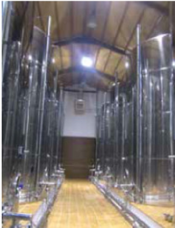
Reservatório de aço-inoxidável
